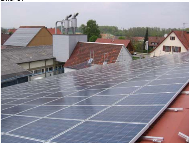
Bild 2+3: Fotovoltaik Gemeinschaftsanlage Löchner GbR in Wolpertshausen
